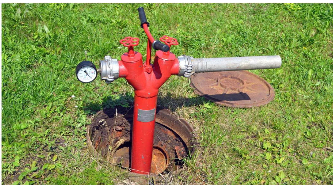
Испытания пожарных гидрантов
