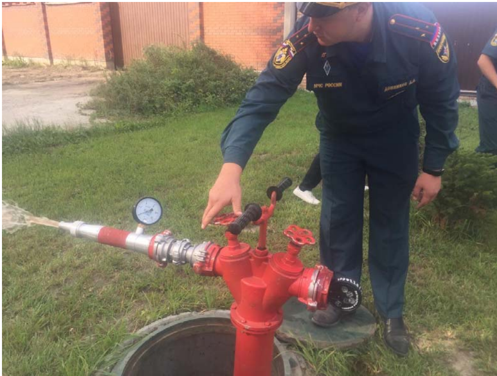
Проверка наружного противопожарного водопровода на водоотдачу
